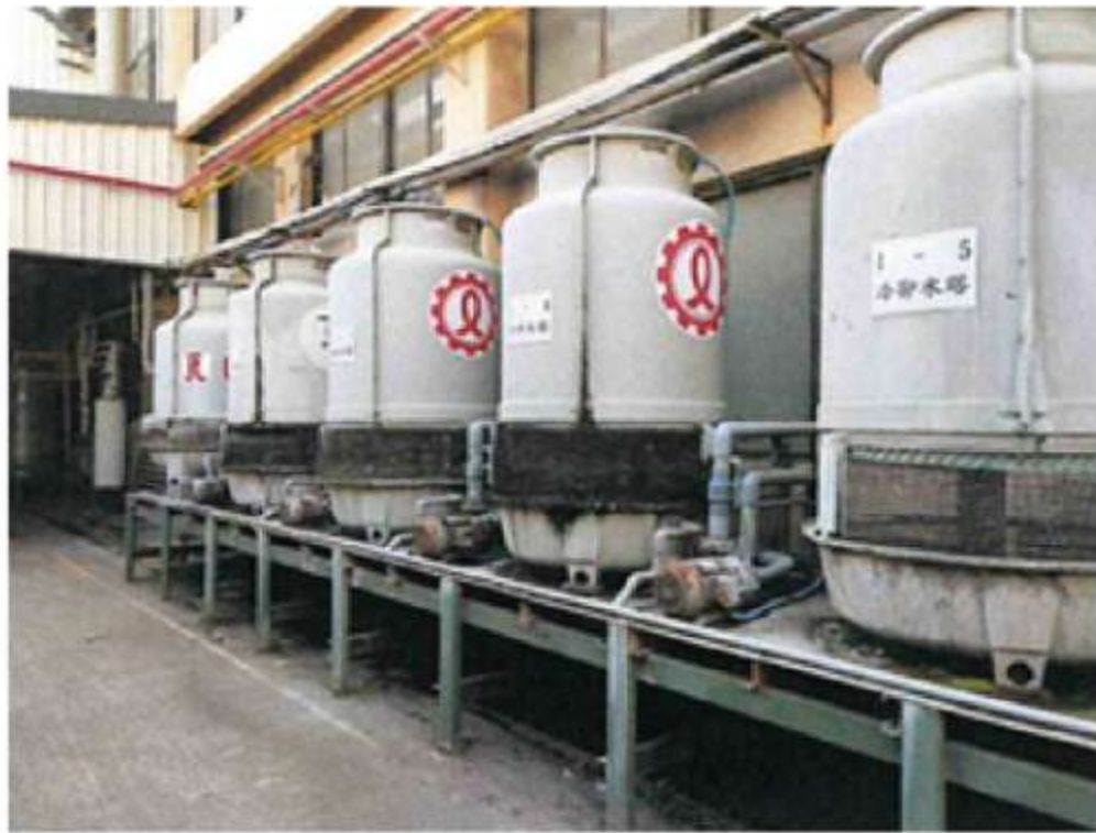
2019年更新冷卻水塔
